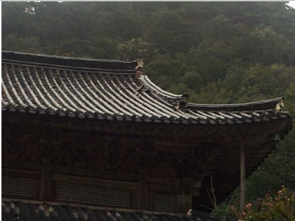
구례 화엄사 각황전 지붕기와 파손
