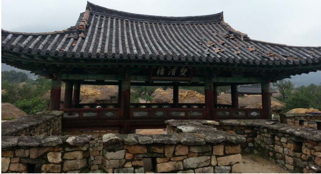
순천 낙안읍성 내 남문 쌍청루 기와 파손
