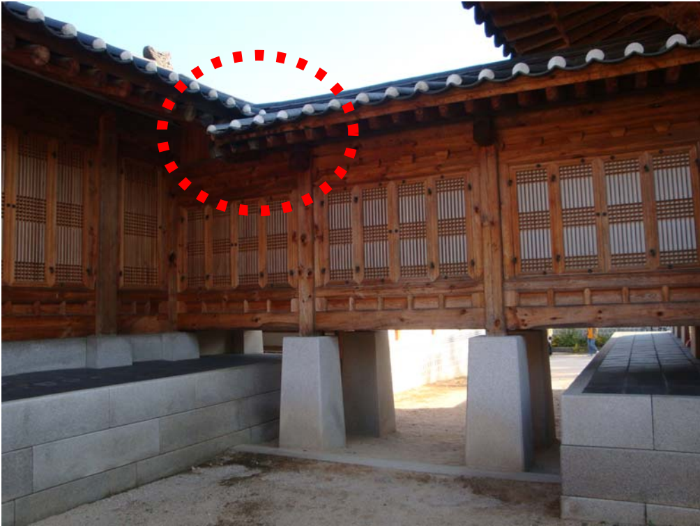
건청궁 장안당과 곤녕합 연결복도 지붕 누수 전경
