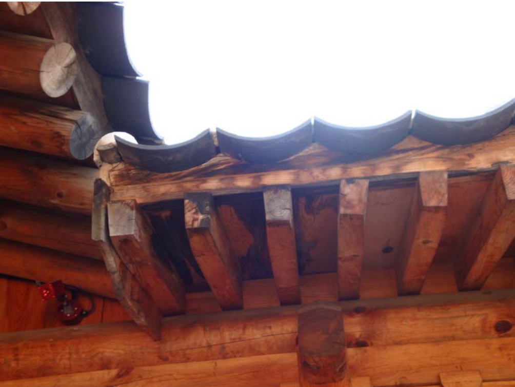
건청궁 장안당과 곤녕합 연결복도 지붕 누수 상세
