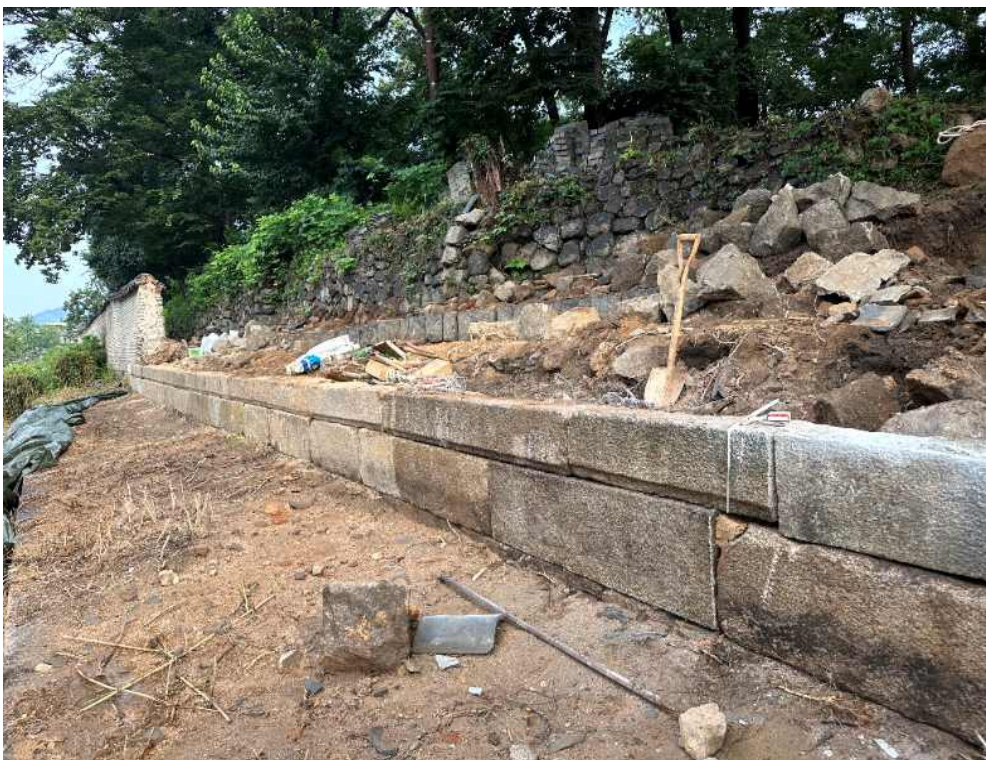
<창덕궁 인정전 배면 담장 호우피해 부분 장대석 해체 드잡이 후>
