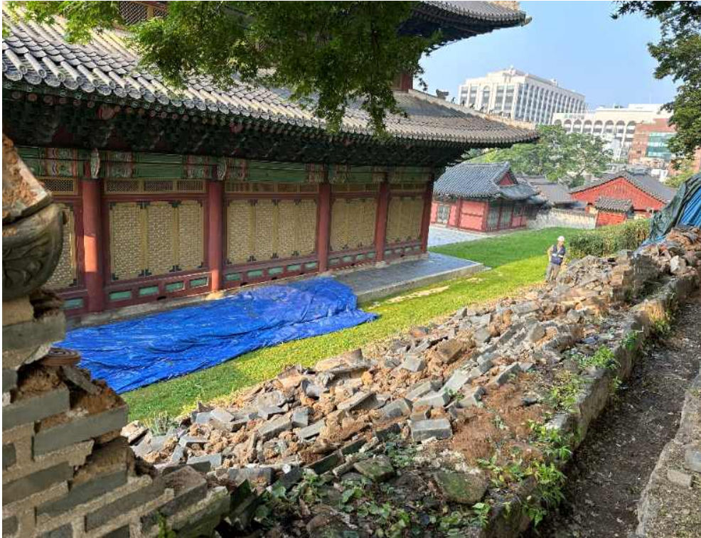
<창덕궁 인정전 배면 담장 호우피해 현황>
