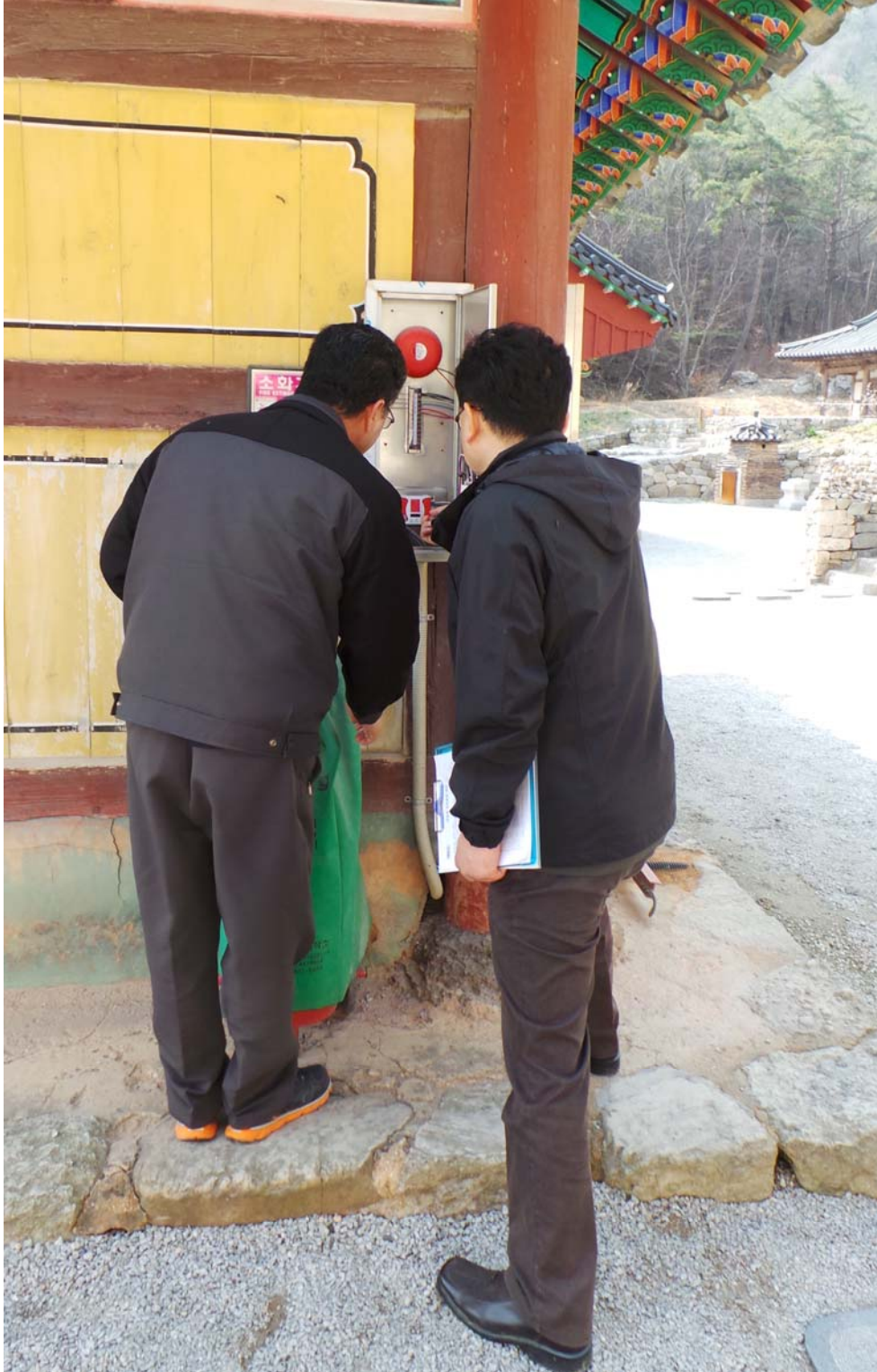
<부안 내소사 발신기 작동기능상태 점검>
