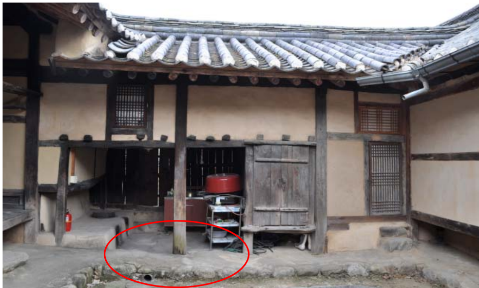
<낙숫물이 기단 내부로 떨어져 기둥 하부 부식>
