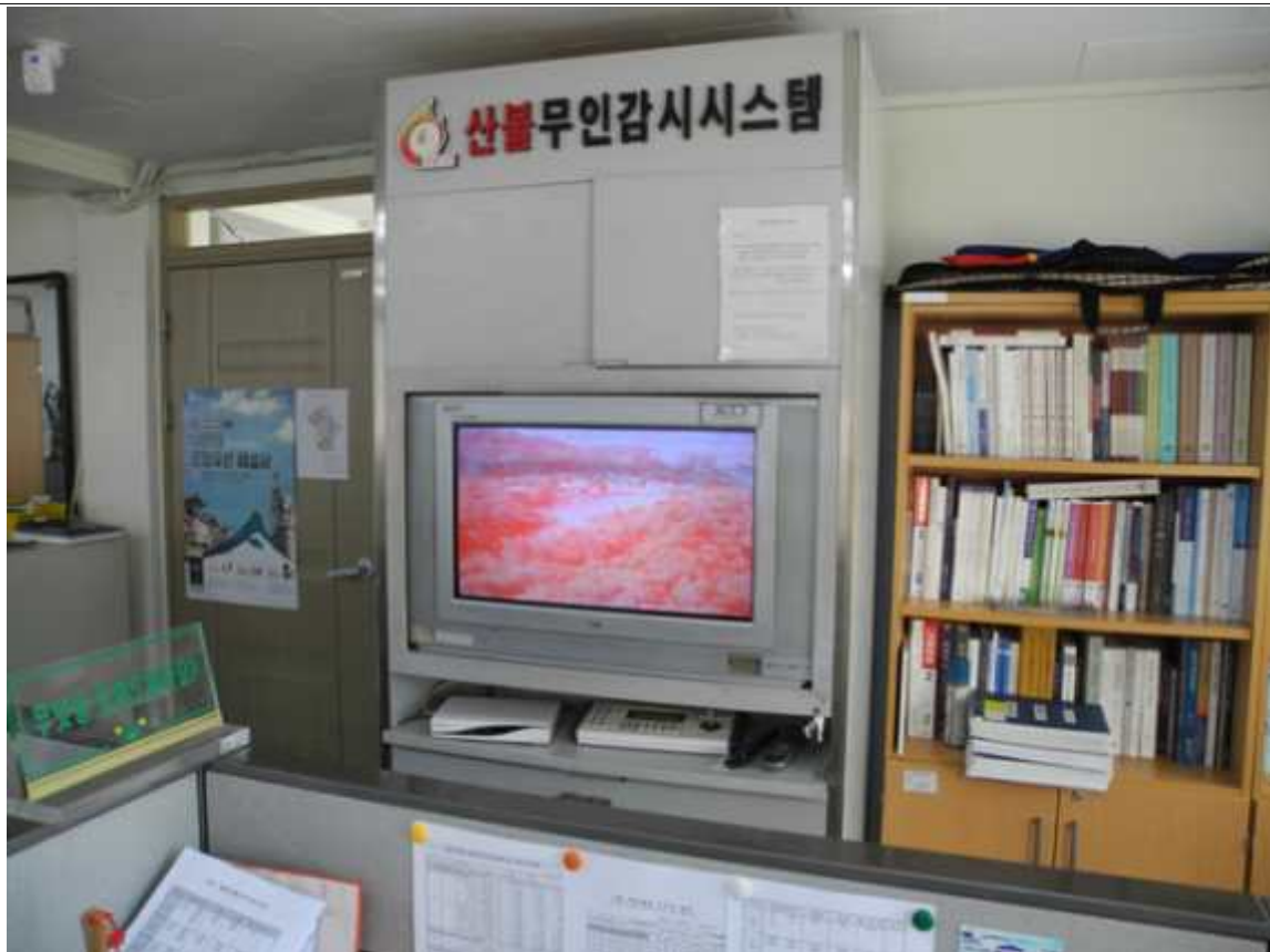
기존 모니터 설치 상태
