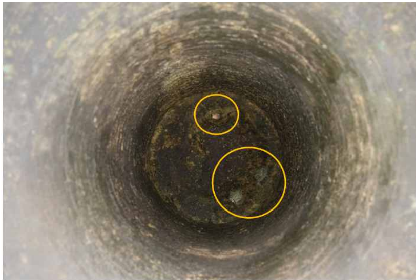
받침 상단부 상태 및 소공
