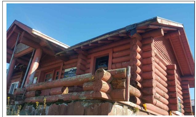
외벽 구조체(목재) 부패 및 기초 박락
