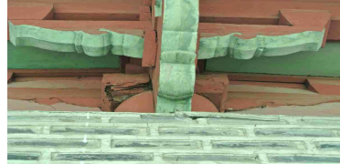
(주두 균열 및 부재 이격)
