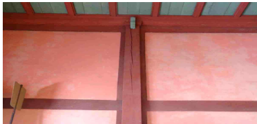
(기둥 수직 균열)
