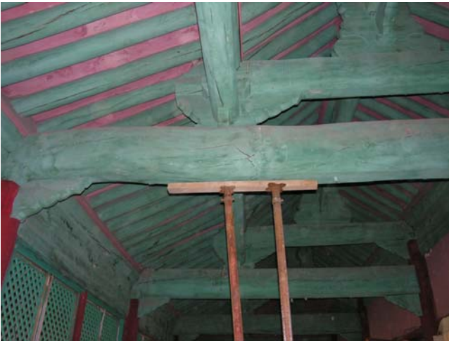
대량 균열로 임시조치
