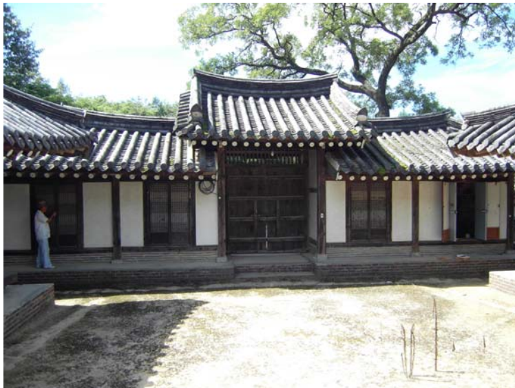
기단의 변형(적벽돌 시공)
