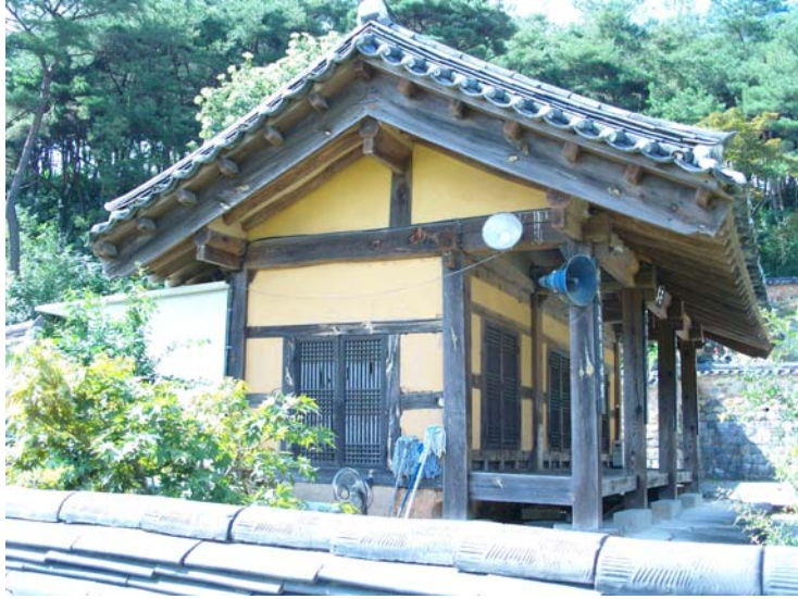
확성기 설치로 어울리지 않음
