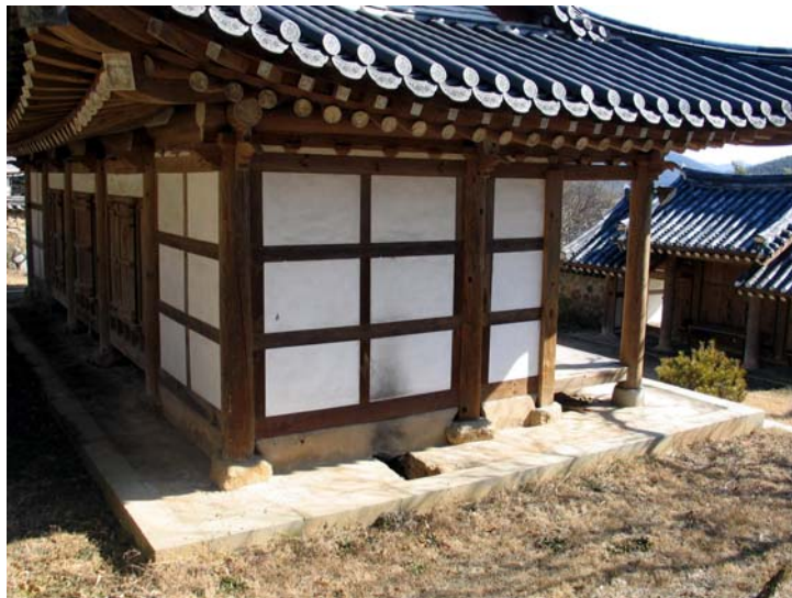
기단의 변형·화강석 가공설치로 건물과 부조화
