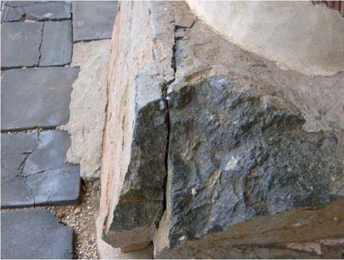
주초석 균열 및 박리
