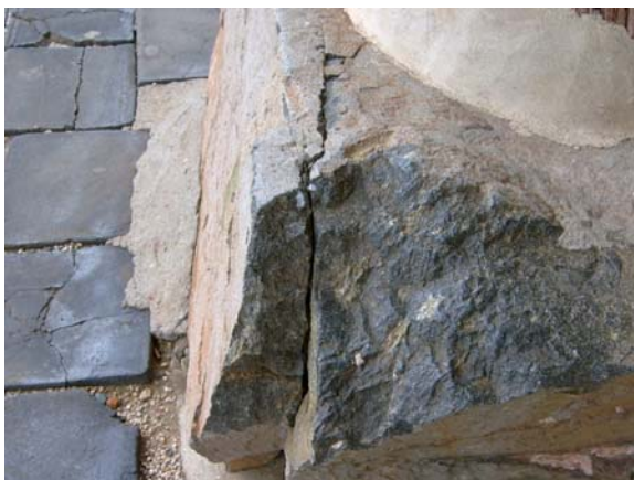
주초석 균열 및 박리
