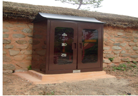
그림 5. 옥외소화전과 연결되어 설치된 호스릴 설비
