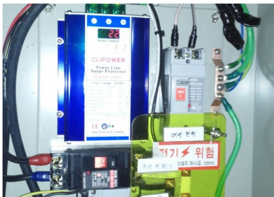
그림 11. 참담암 낙뢰보호기 설치
