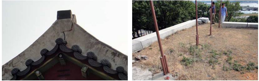
옹마루 균열 및 배수처리 문제 확인
