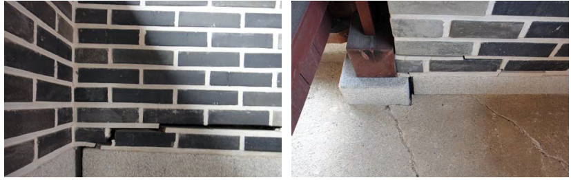
출눈부위 균열로 인한 이격 및 바닥 균열, 침하
