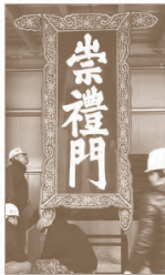
승례문 화재 4주년을 하루 앞둔 5월 20일 부산 역사문화재 관리처의 직원들이 단청을 하고 있다. 위 사진은 10월 복구 공사 현장의 모습이다.
