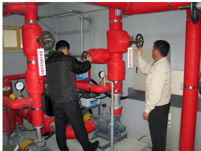
전문가에 의한 소방 설비 정기점검 좌: (사)문화재예방관리센터 우: 보은 법주사
