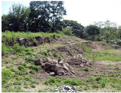
발굴지 현장 토사유실 및 붕괴가 우려됨
