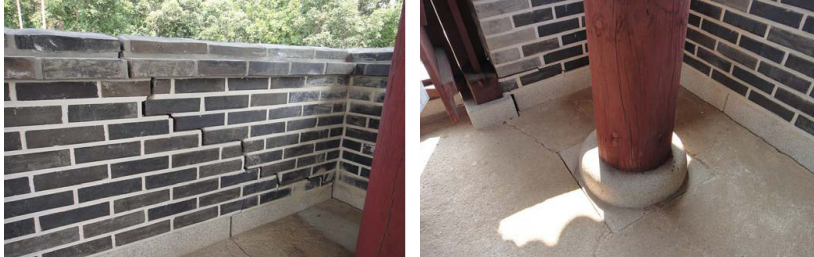
여장부 균열 발생 및 초석침하, 바닥균열 발생
