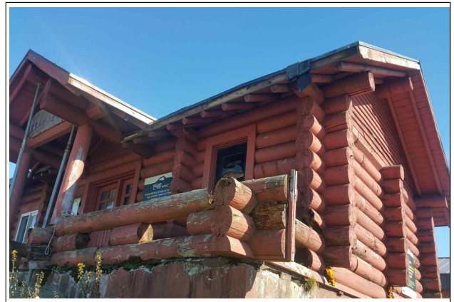
외벽 구조체(목재) 부패 및 기초 박락
