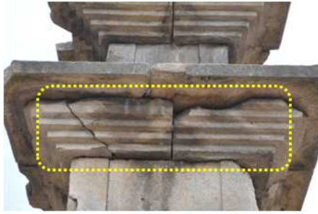
그림 3.13 경주 고선사지 삼층석탑 (옥개석 균열)
