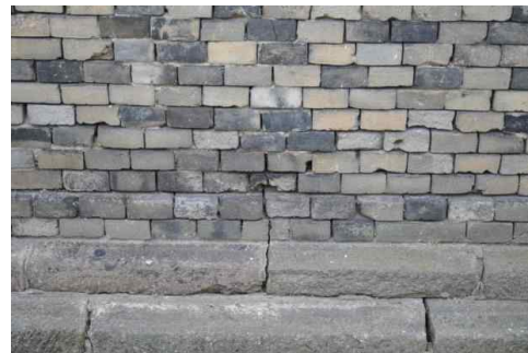
그림 3.17 안동 운흥동 오층전탑 (수직 균열)
