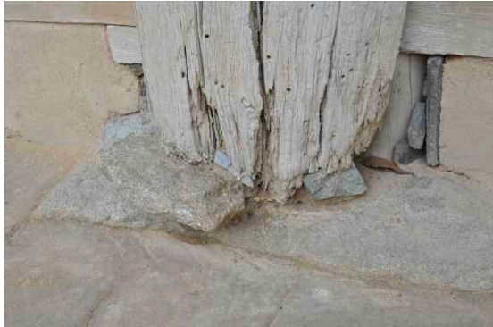
그림 3.28 영천 은해서 거조암 영산전 (기둥 하부 부식)
