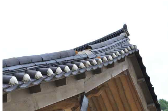
그림 3.38 영천 은해서 거조암 영산전 (기와 탈락)
