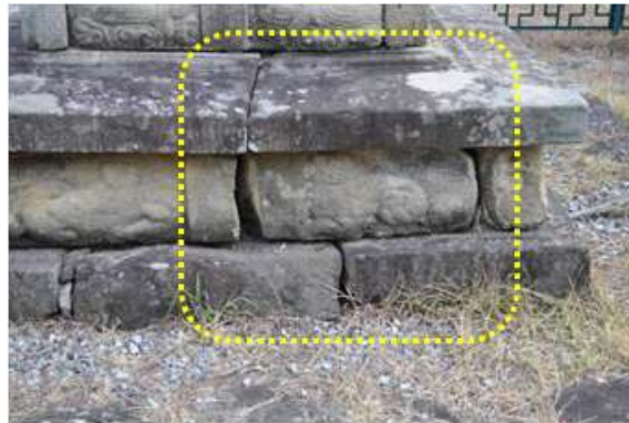
그림 3.12 군위 지보사 삼층석탑 (지대석 면석 균열)
