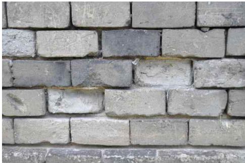
그림 3.16 안동 운흥동 오층전탑 (전돌 파손)
