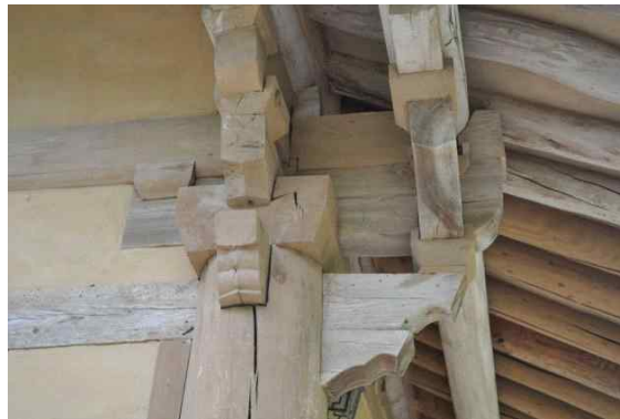
그림 3.36 영천 은해서 거조암 영산전 (기둥 상부 및 주두 균열)
