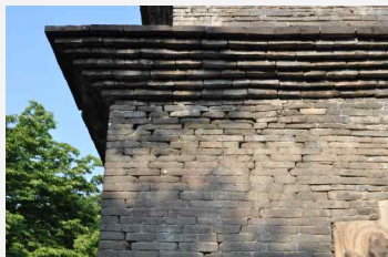
전돌 균열 및 이격
