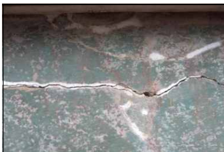
과거 보강부위 균열(제석천)
