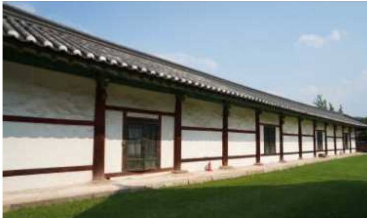
그림 56 경주향교 동무의 마당측 입면 - 3칸 단위로 가운데 문을 두었는데, 제2칸의 출입문만 다르다. (2020년 9월 8일 촬영)
