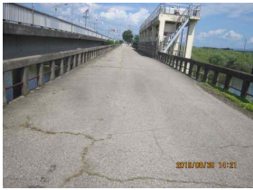
그림 11 교량 슬래브 포장면 균열 및 탈락
