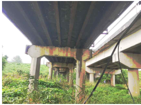
그림 10 교량 슬래브 하면 균열 및 백테와 일부 철근 노출, 부식된 I형강
