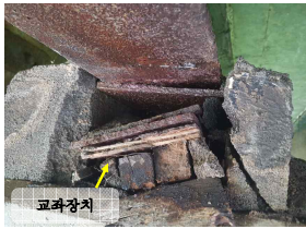
그림 12 교좌장치 파손 및 이완
