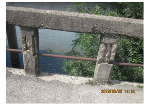
그림 14 난간기둥 파손 및 강관난간대 부식
